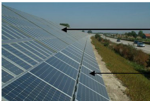
Figuur 3. 4 Freising, 500kWp geluidsbarrière met keramisch gebaseerde PV – modules (GROTTKE et al, z.d.)
