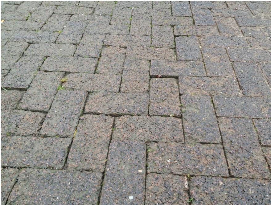
Figuur 58: Puurs, Robert Verbelenstraat: schade aan straatstenen
