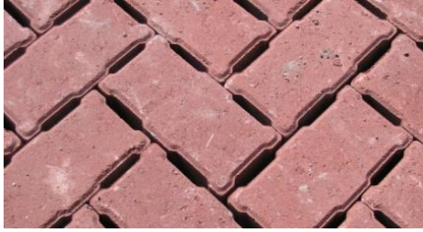
Figuur 4: Betonstraatsteen met verbrede voegen.
