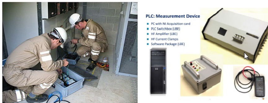
Figuur 1.6: Installatie en apparatuur voor performantietesten van PLC
