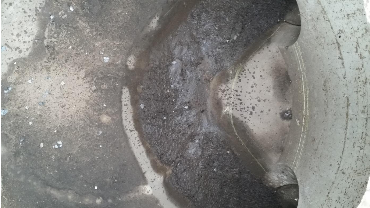
Figuur 32: Meevoering zand in RWA-riolering
