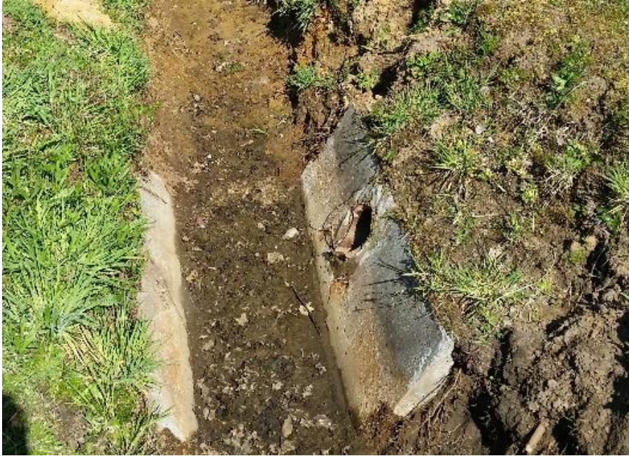
Figuur 24: Gracht met aansluitende RWA wachtbuizen Mommersbosweg Zonhoven
