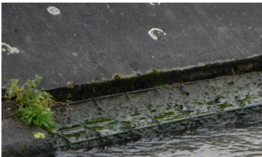
Figuur 12: Wapening bloot door slecht beton
