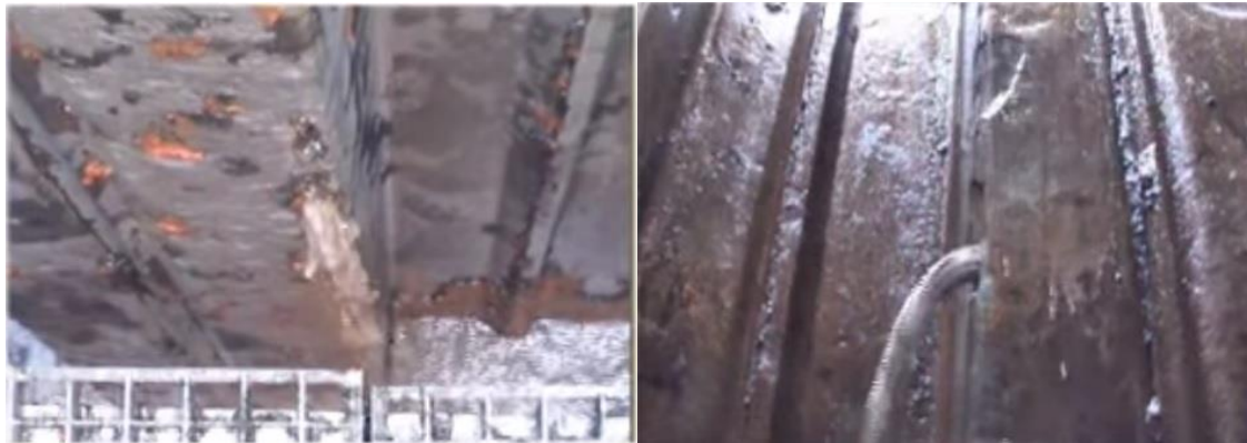
Figuur 9: Gaten in stalen damplank door corrosie
