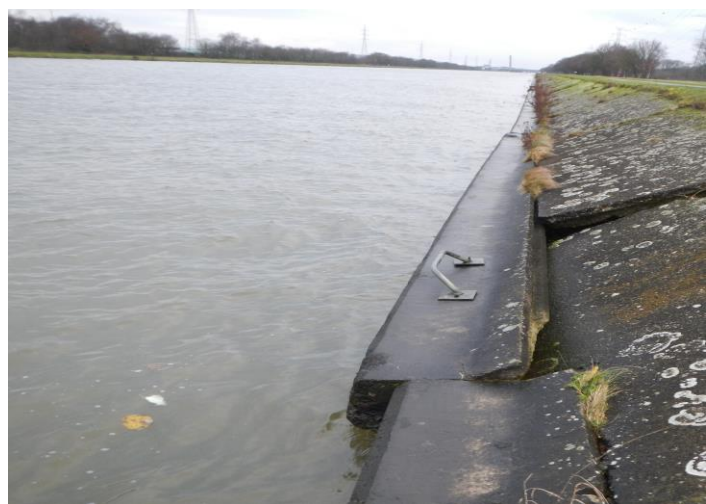
Figuur 1: Schade aan de damwand en taludplaat langsheen het Albertkanaal
