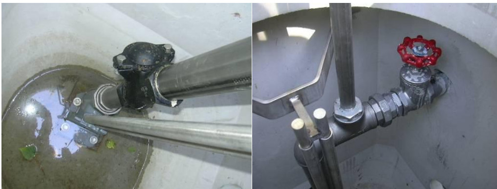
Figuur 3: Stijgleiding met balkeerklep (l) en afsluiter (r)
