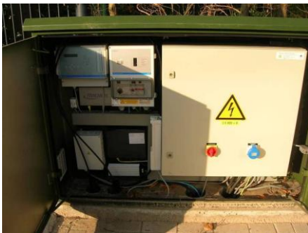
Figuur 5: Centrale voedingskast
