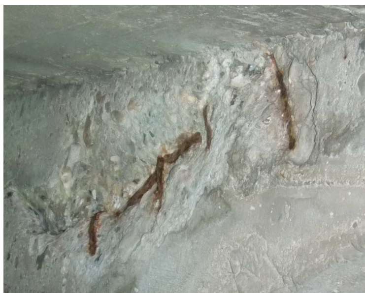
Figuur 4: Carbonatatie waargenomen in de Deschaneltunnel
