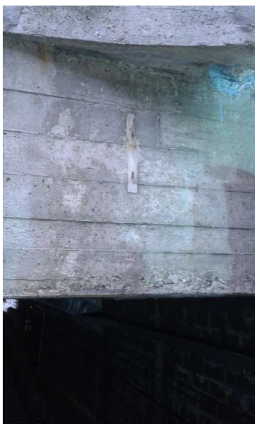
Figuur 33: Ongewenste metalen in het beton
