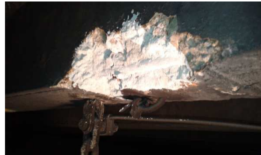
Figuur 40: Betonafbrokkeling ter hoogte van de aansluiting van de stroomleiding
