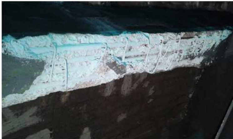
Figuur 47: Vastgestelde pathologie in het verleden verkeerd gerepareerd
