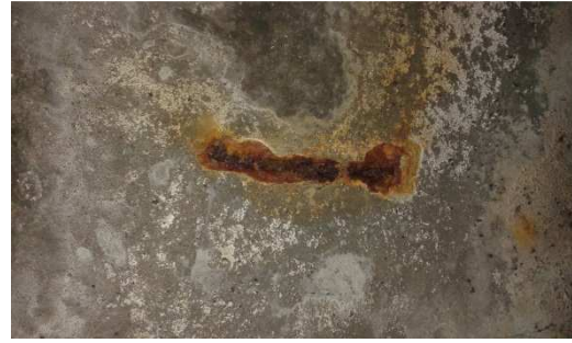
Figuur 38: Blootliggende wapening met weinig betondekking
