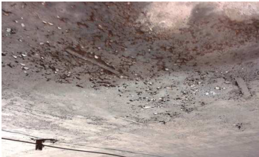
Figuur 39: Grindnest en vervuiling van bekisting
