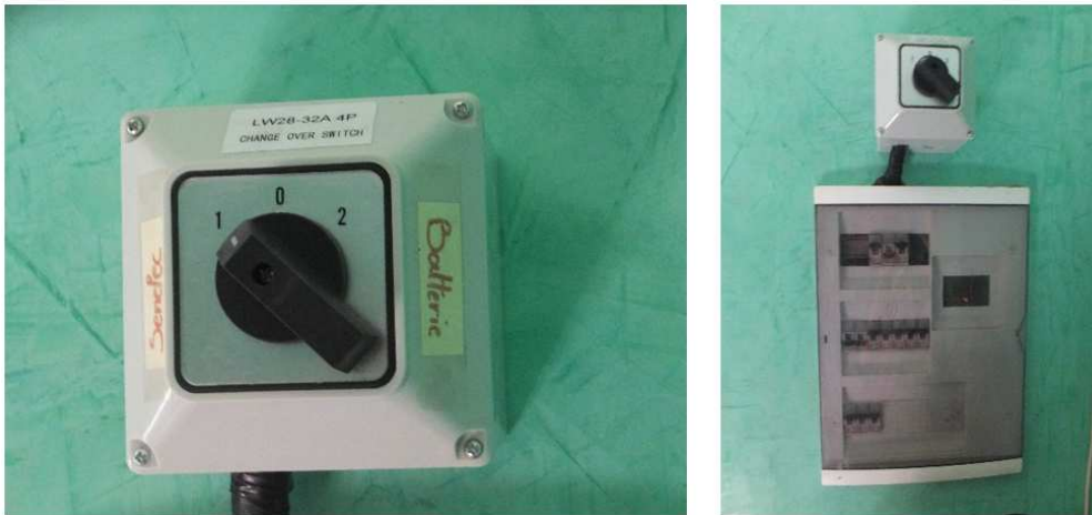
Figuur 43: Installatie netschakelaar
