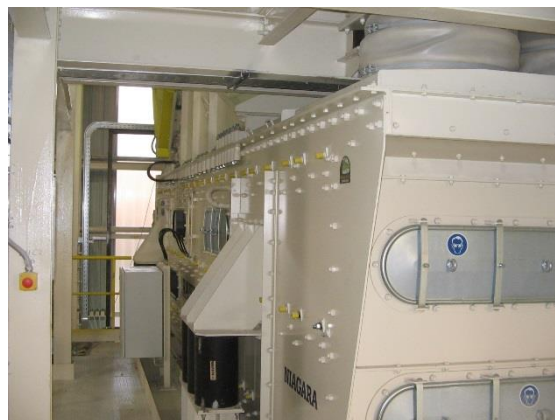
Figuur 39: Nieuwe zeefinstallatie
