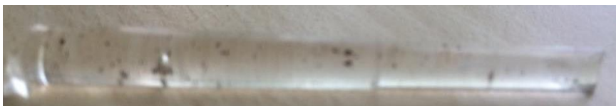
Figuur 32: Degradatie zichtbaar in de aansluiting van het product
