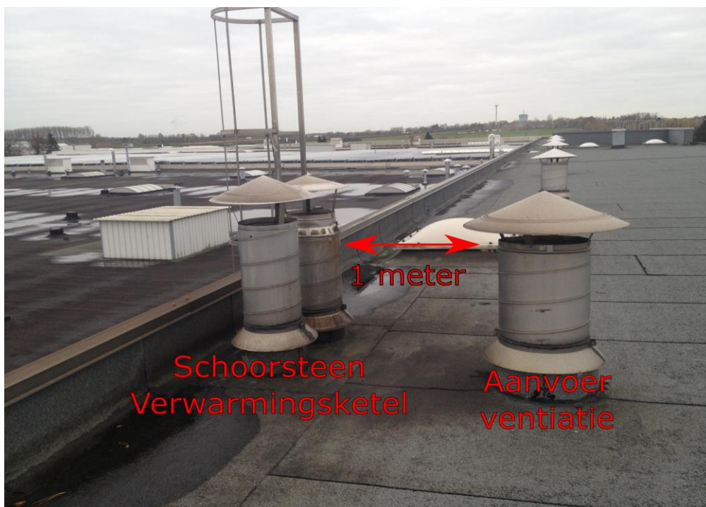
Figuur 40: Probleem met ventilatie in MRD6
