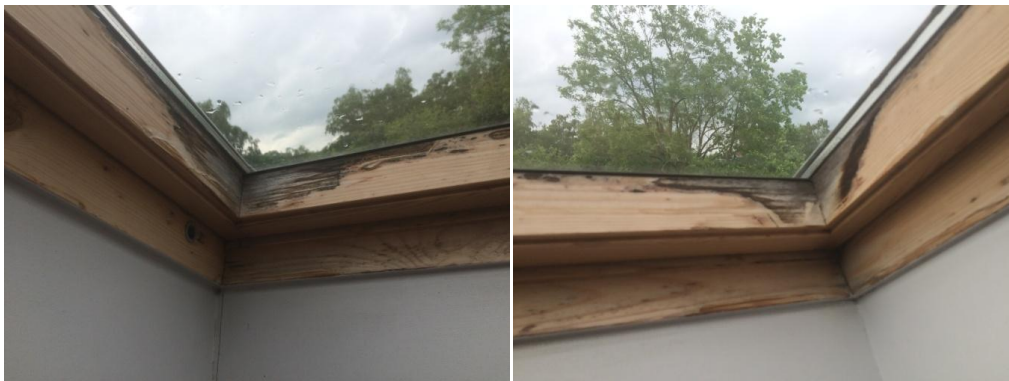
Figuur 66: Aantasting houten dakvenster in badkamer
