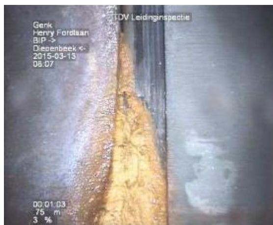
Figuur 11: Grondstroom door de openstaande voeg, Henry Fordlaan te Genk
