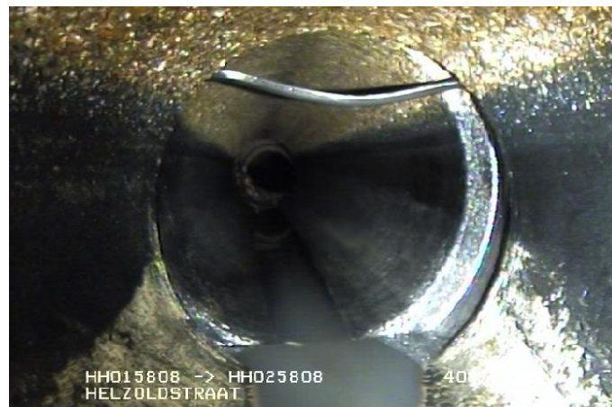
Figuur 6: Indringing afdichtingsmateriaal [foto uit inspectievideo's]
