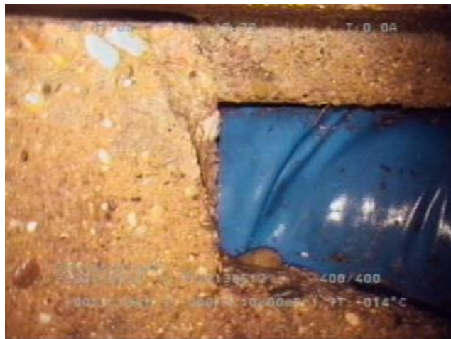
Figuur 7: Oppervlakteschade [foto uit inspectievideo's]
