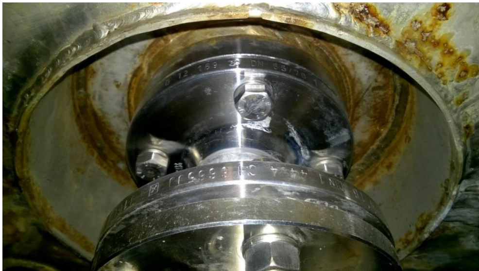
Figuur 26: Vrije ruimte flens koppeling mengtank 20000L
