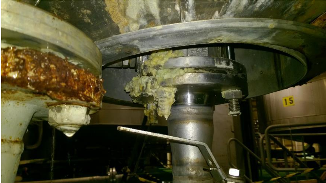
Figuur 6: Lek flenskoppeling mixer - zuigleiding mixer 17
