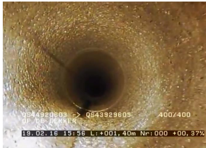
Figuur 18: Beeld in de buis van camera-inspectie
