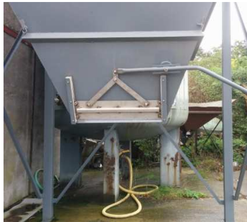
Figuur 4: De handbediende klep van de reeds aanwezige grondstof silo.
