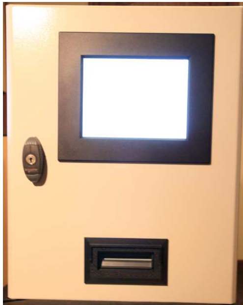
Figuur 25: De installatiekast bij het weegbrughuis met de bedieningsdisplay en de ticketprinter.
