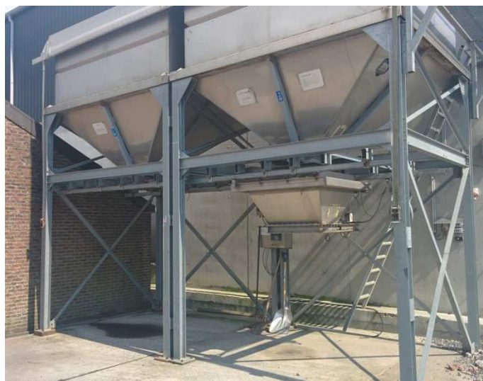
Figuur 1: Opstelling van de silo's met het mobiele weegstelsel eronder.
