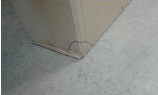
Figuur 29: foto van de hoek waarop de valproef is uitgevoerd
