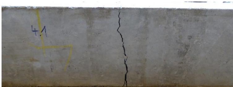
Figuur 30: Schadepatroon proefstuk van samenstelling 4
