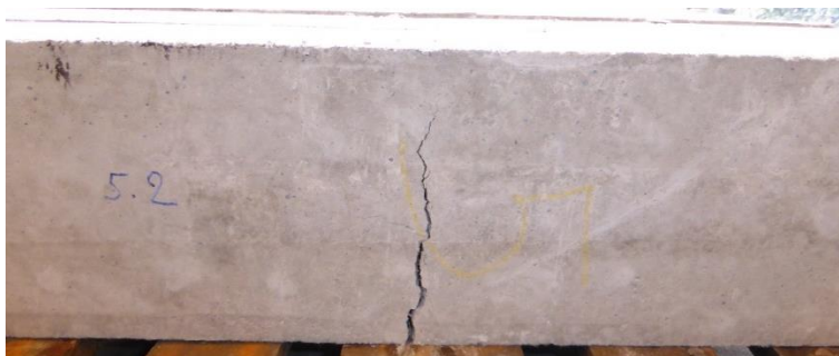
Figuur 31: Schadepatroon proefstuk van samenstelling 5
