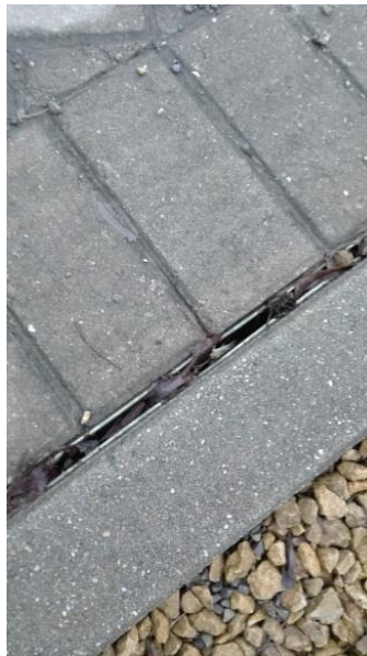
Figuur 53: Sleuf met niet poreuze betonstraatstenen
