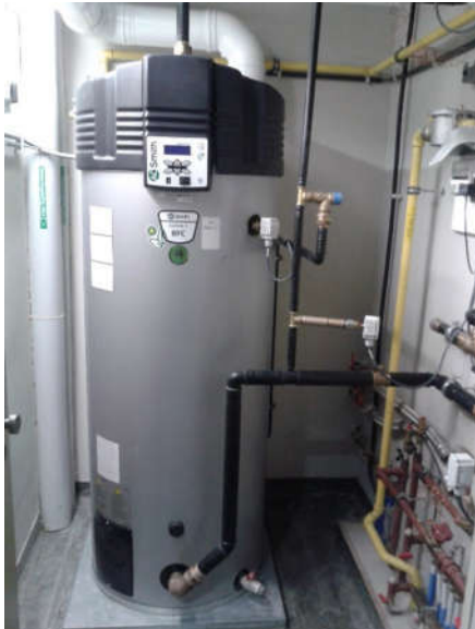
Figuur 16 SWW boiler Demerhof blok B
