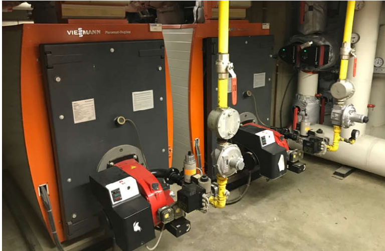
Figuur 67 Technische ruimte (oud gebouw) Den Akker
