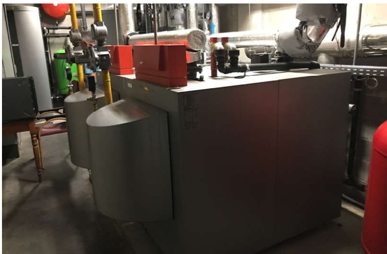
Figuur 68 Technische ruimte (nieuw gebouw) Den Akker
