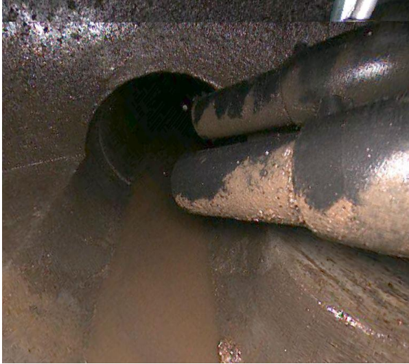
Figuur 33: Uitlaat drukriolering naar aanliggende buis – inspectieput QS23647110
