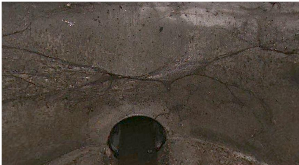
Figuur 20: QS19875802 – scheurvorming
