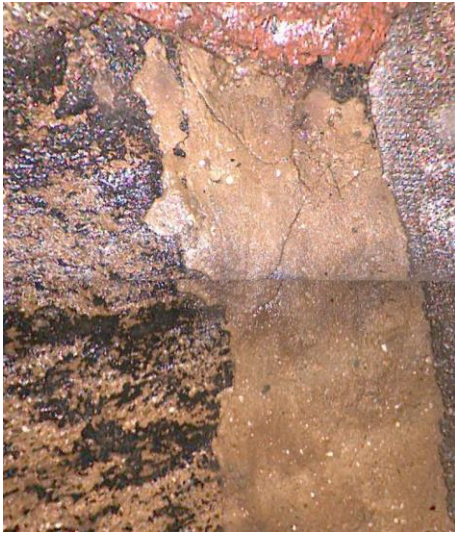
Figuur 27: QS33826103 – duidelijke aantasting: scheuren zichtbaar
