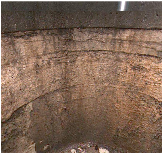
Figuur 22: QN39013801 - duidelijke aantasting: scheuren en granulaten zichtbaar
