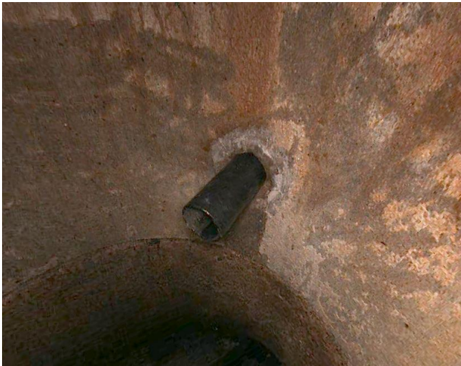
Figuur 34: Uitlaat drukriolering in inspectieput
