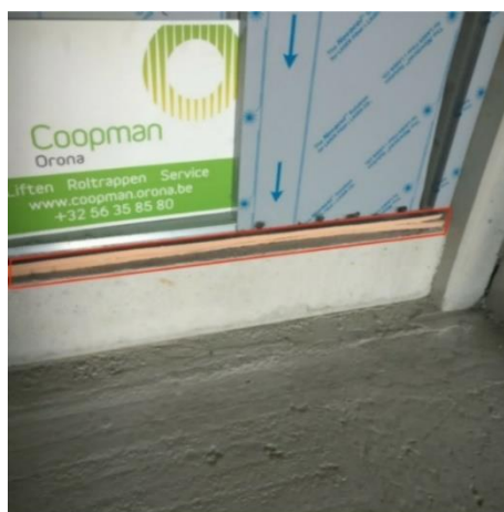
Figuur 26: Luchtdichting liftdeuren
