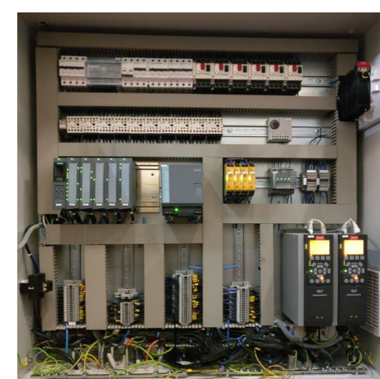
Figuur 6: Nieuwe schakelkast
