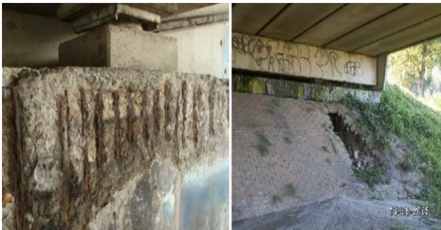
Figuur 30: Schadebeelden bij niet waterdichte brugvoegen [5]
