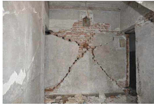
(d) Wall piece broken and extroversion
