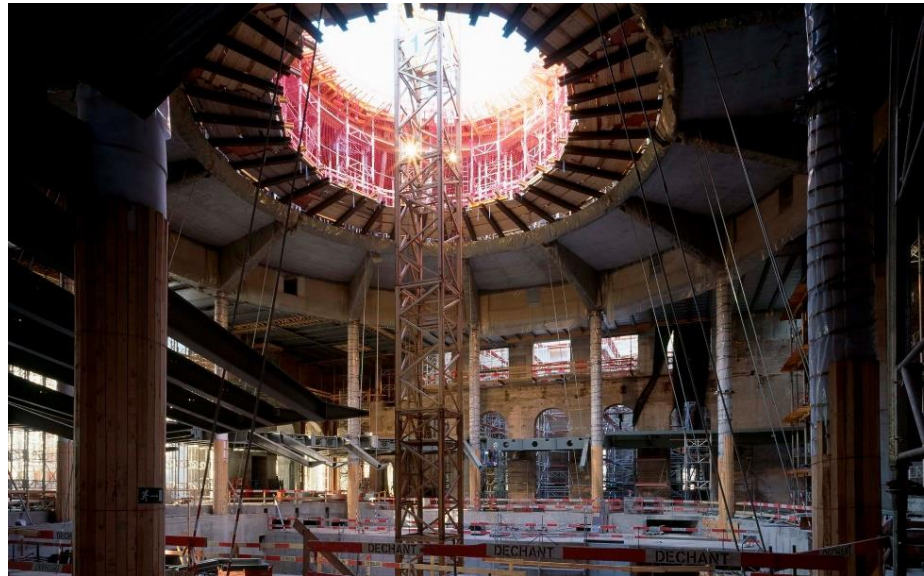
Figuur 5. Constructie van de Reichstag. Overgenomen uit Reichstag, New German Parliament van Onbekend, z.d. ( https://www.fosterandpartners.com/projects/reichstag-new-german-parliament/ ). Copyright 2019, Foster + Partners.
