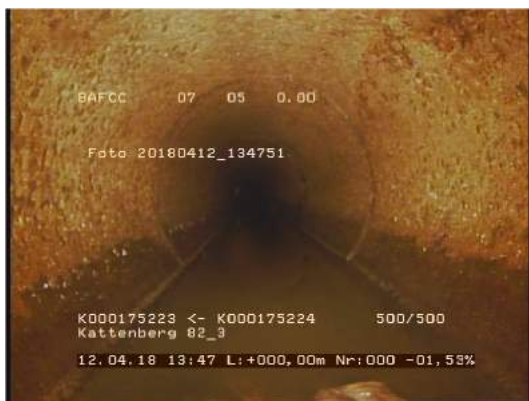
Figuur 1.5: Oppervlakteschade door chemicaliën [7]
