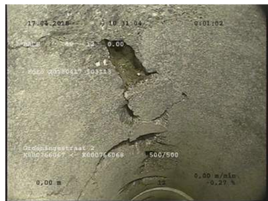
Figuur 1.4: Breuken en scheuren in de buiswand [7]
