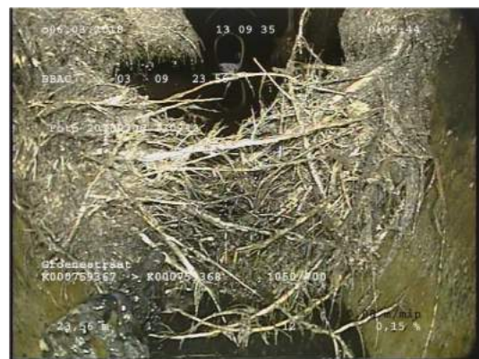
Figuur 1.6: Rioolschade door wortelindringing [7]
