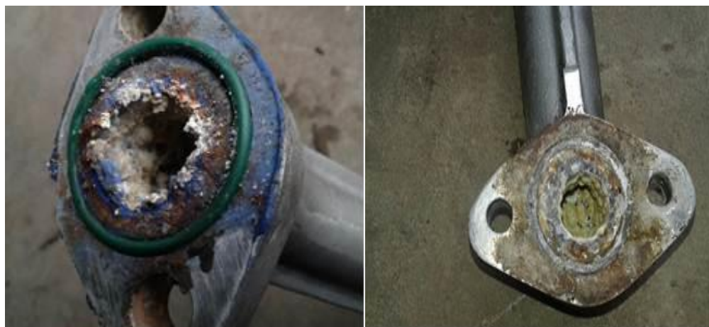
Figuur 24: Vuilafzettingen in het koelcircuit van de compressoren
