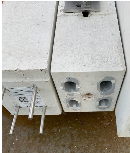
Figuur 28: Verstifting bij gevelkolommen (links: stiften onderaan kolom – rechts: ingestorte ovale hulzen bovenaan kolom)
