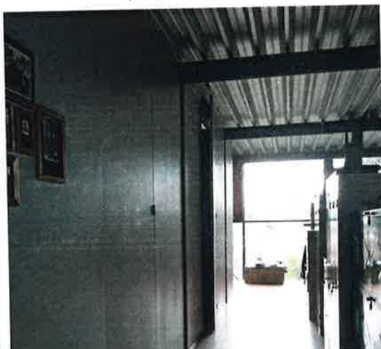
Figuur 55: Kabelgoten voor leidingen
