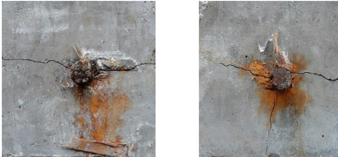
Figuur 16: Scheurvorming als gevolg van splitting stress [40]
