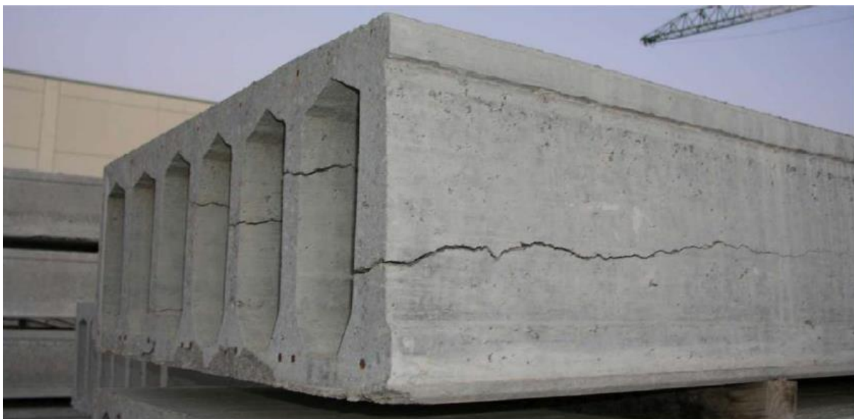
Figuur 13: Scheurvorming als gevolg van spallingspanning [1]
