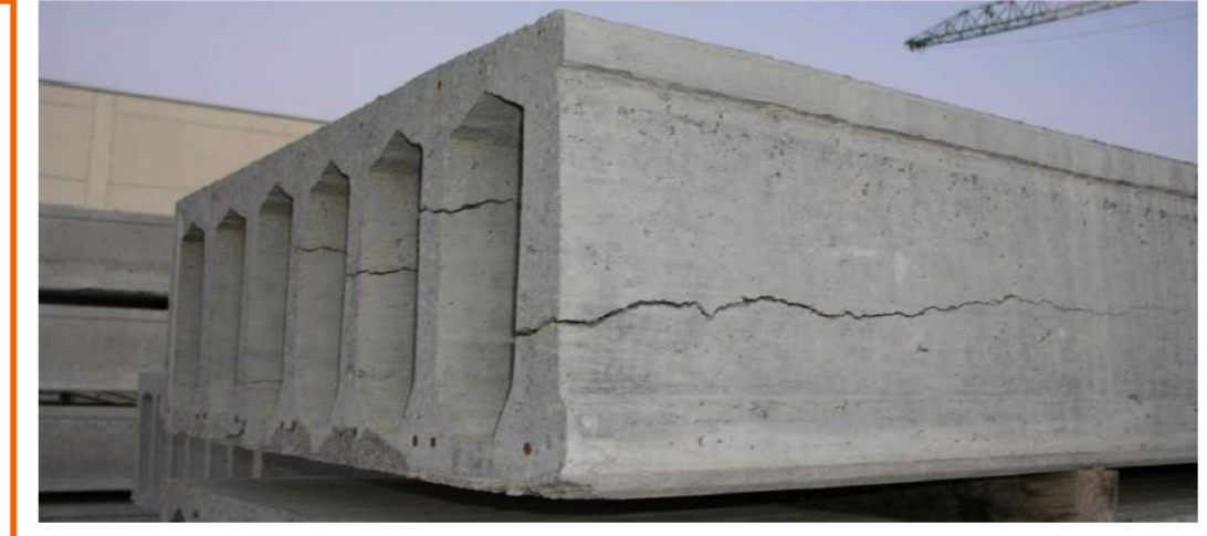
Figuur 1: Scheurvorming t.g.v. spallingspanning [1]
