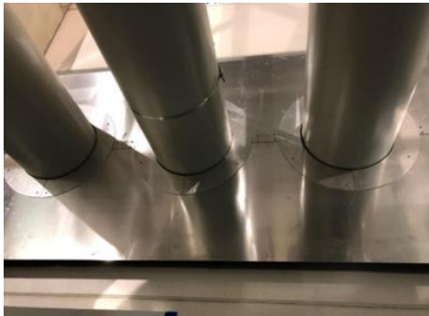
Figuur 3: Metalen omkadering/plaat aan buitenmuur van een GIS-installatie [5, p. 20]
