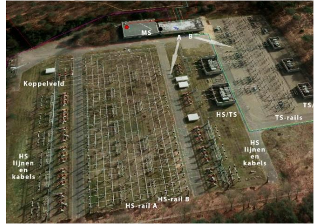
Figuur 11: Een hoogspanningsonderstation [9]
