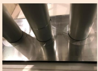
Figuur 1: Muurdoorgang in een GIS-onderstation [2, p. 20]
