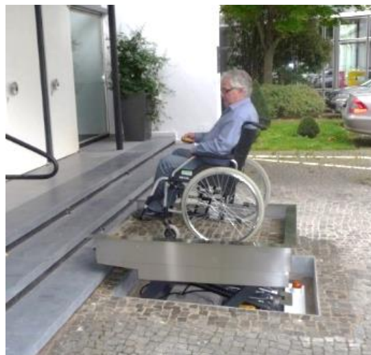
Figuur 19: Rolstoellift verwerkt in de vloer [2]
