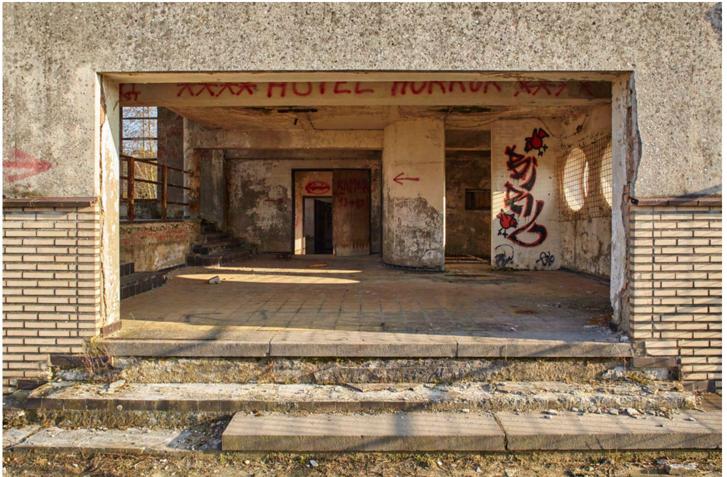
Afb. 12: Resultaat van de degradatie aan het cafetariagebouw
