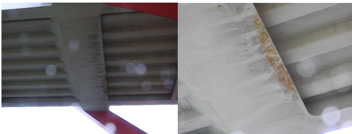
Figuur 13: Corrosie ten gevolge van vochtophoping in dwarsligger
