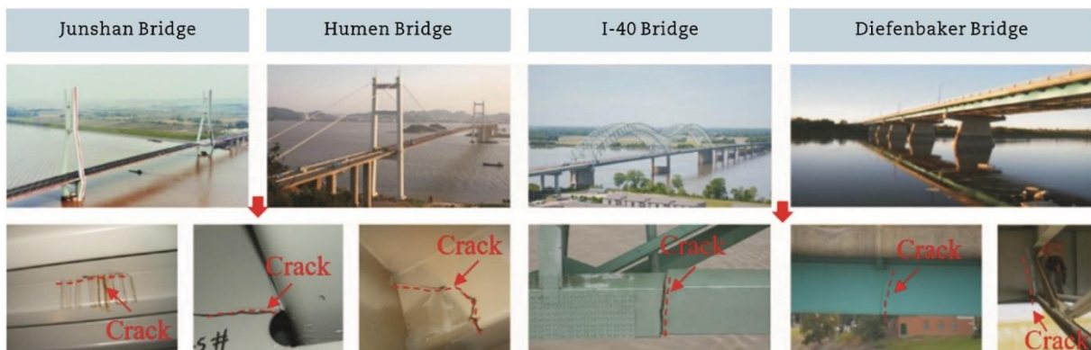
Figuur 1: Vermoeiingsscheuren in stalen bruggen [4]
