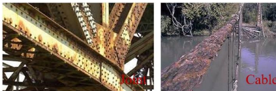
Figuur 2: Corrosietypen naar aantastingslocatie. (a) Oppervlaktecorrosie (b) Kabelcorrosie [4]
