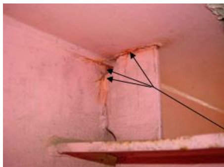
Figuur 5: Scheurvorming ter hoogte van verbinding [5]
