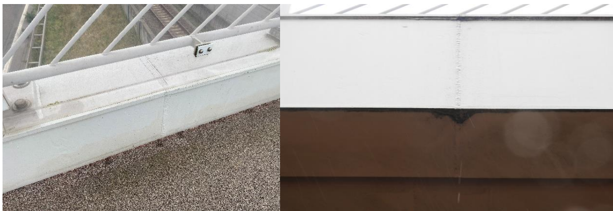
Figuur 12: Corroderende lasverbinding van langsligger
