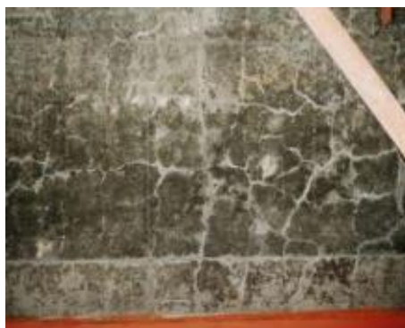
Figuur 6: Scheurvorming betonplaat [5]
