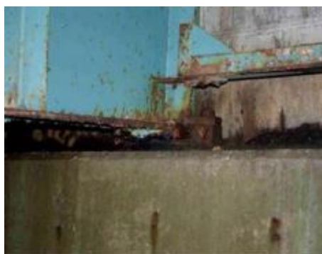
Figuur 4: Corrosie aan het uiteinde van een ligger [5]
